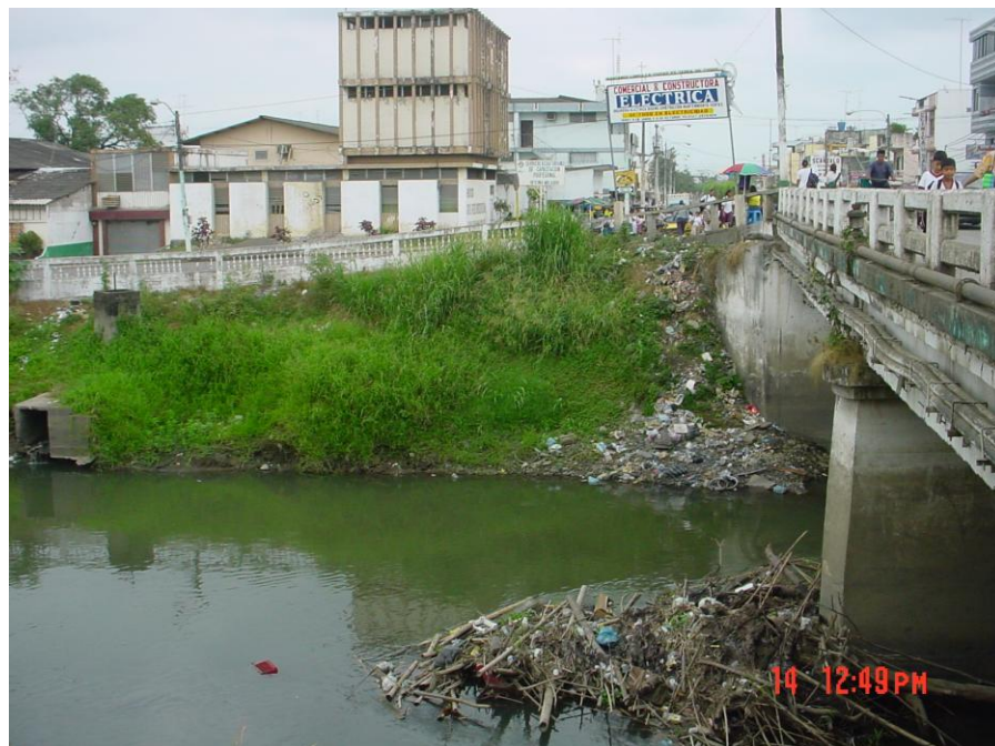
FIGURA 22. ACUMULACIÓN DE BASURA BAJO EL PUENTE 17 DE SEPTIEMBRE
