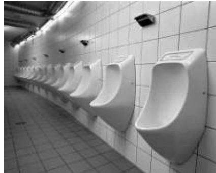
Figura 1. Batería sanitaria con el URIECO instalado
