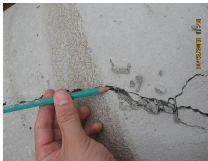
Foto 5.2.1.2 Fibras de acero actuando en las fisuras para impedir la separación total del elemento en la zona de rotura
