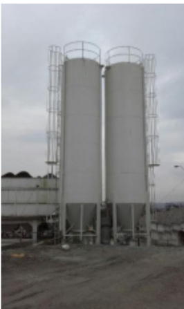
Ilustración 0.7 Silos de Almacenamiento de Hormigón
