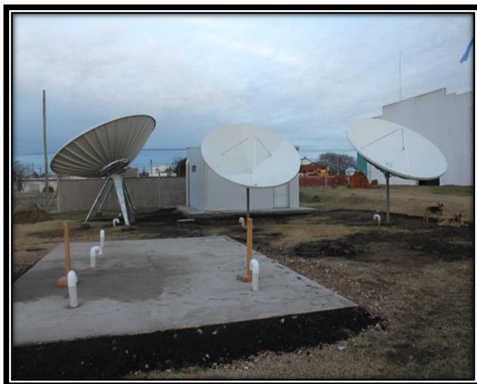
Figura 4. 36. Recepción Satelital Antenas de CLARO.
