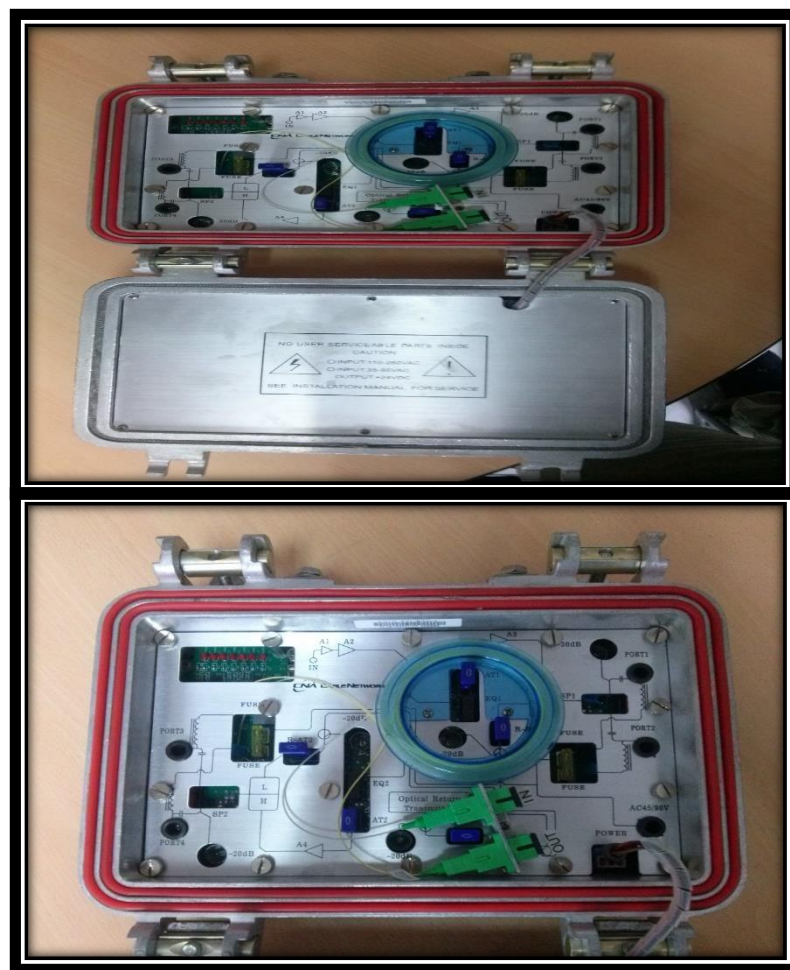
Figura 4. 46. Nodo De Fibra Óptica ubicado en Manta
