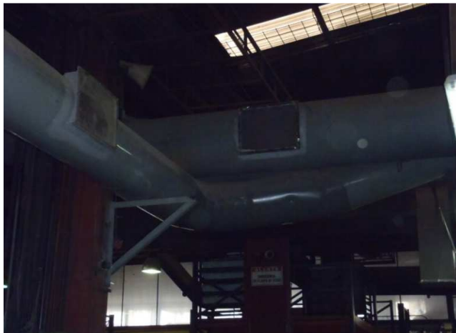
FIGURA 4.6 COMPUERTAS DE LIMPIEZA INTERIOR DE DUCTOS
