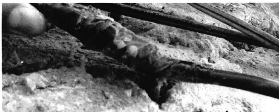
(Figura 2-2) Acometida con bypass.
