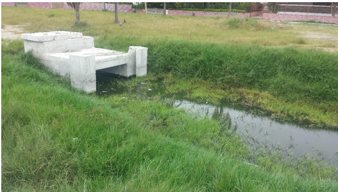
Figura 18. Alcantarilla abierta en el sector de San Lorenzo, Salinas. Fuente: Propia
