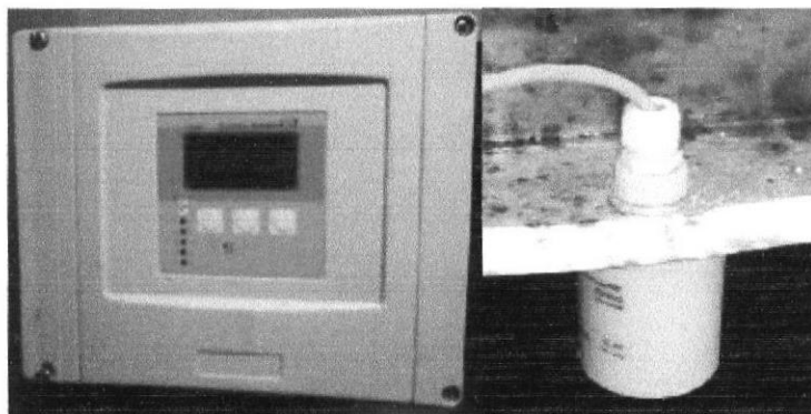
Figura 3.4 Sensor y transmisor de nivel
