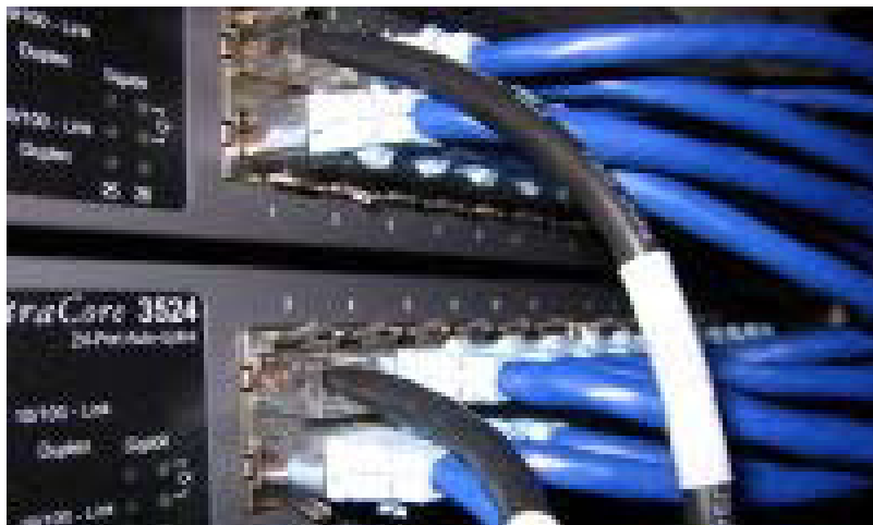
Figura 41: Conexiones en un switch Ethernet
