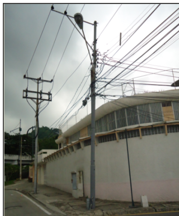
Figura 1.1 Poste ubicado en la ciudadela Los Ceibos calles Elio Estévez Bejarano y Av. Primera.
