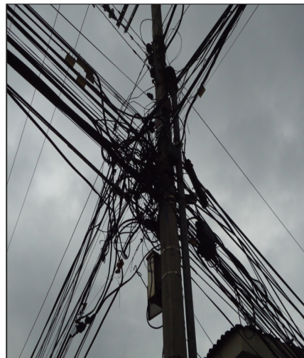
Figura 1.13 Poste ubicado en la ciudadela Nueva Kennedy, Av. Luis Orrantía y calle Justino Cornejo
