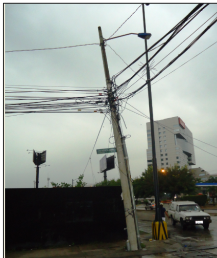
Figura 1.27 Poste ubicado en la ciudadela Nueva Kennedy, Av. Luis Orrantia y calle José Santiago Castillo
