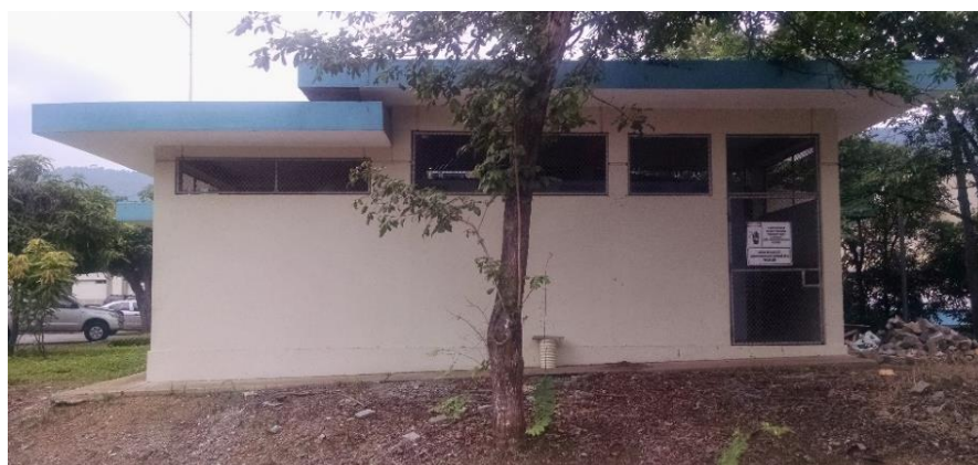
FIGURA 3.57: Cuarto de celdas #3 FIMCP
