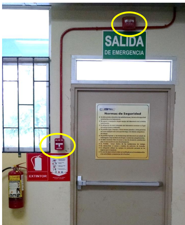
FIGURA 3.2: Sirena y Pulsador manual de alarma del Laboratorio CAMPRO
