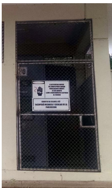
FIGURA 3.4: Cuarto de celdas #03 de la FIMCP
