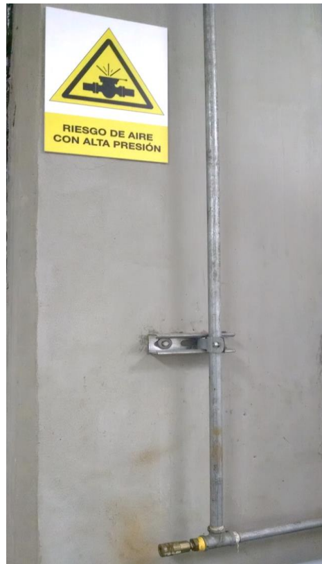
FIGURA 3.16: Tubería de transporte de aire con alta presión del Laboratorio CAMPRO
