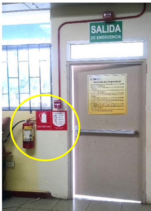
FIGURA 3.6: Extintor de PQS en área de la puerta de emergencia del Laboratorio CAMPRO
