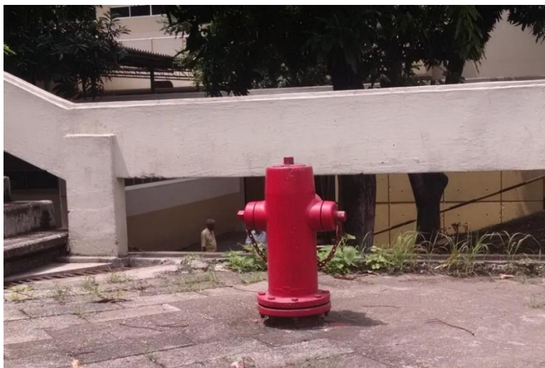
FIGURA 3.5: Hidrante de la FIMCP
