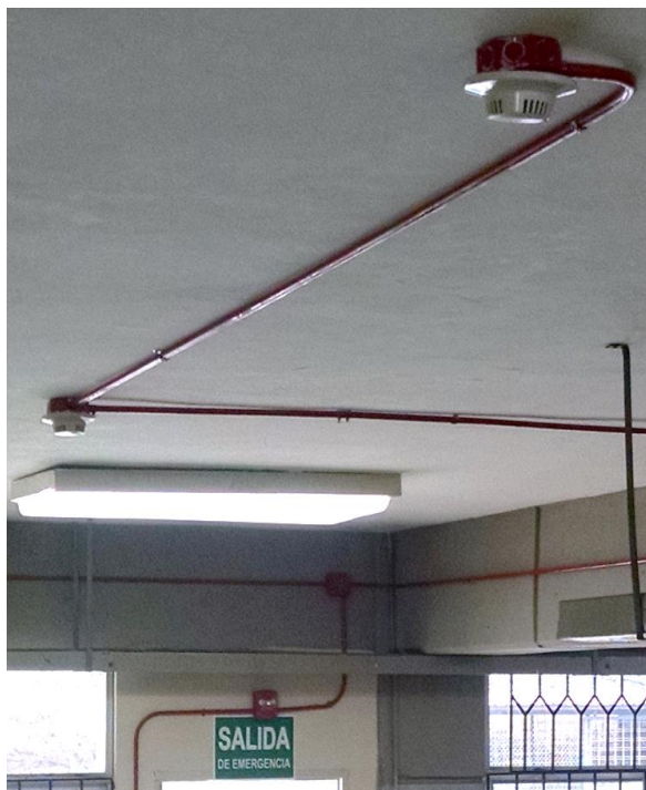
FIGURA 3.54: Detectores de humo del área de trabajo del Laboratorio CAMPRO
