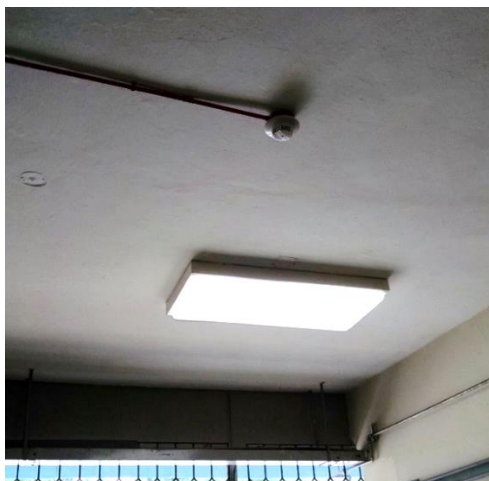
FIGURA 3.53: Detector de humo del área administrativa del Laboratorio CAMPRO
