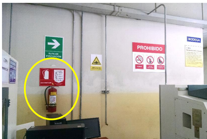
FIGURA 3.7: Extintores de PQS en pared de bodega del Laboratorio CAMPRO
