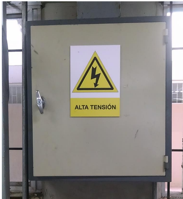
FIGURA 3.13: Señales de Advertencia de Alta Tensión de la caja de breakers del Laboratorio CAMPRO
