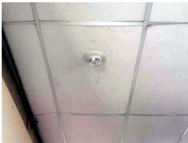
FIGURA 3.55: Detector de humo del área de bodega del Laboratorio CAMPRO
