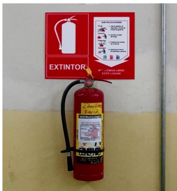
FIGURA 3.59: Extintor 2 de PQS del Laboratorio CAMPRO
