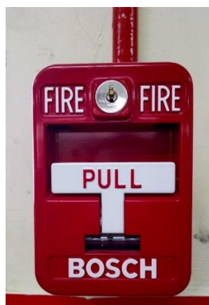
FIGURA 3.52: Pulsador manual de alarma
