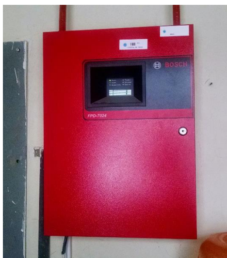
FIGURA 3.56: Panel de Alarmas del Bloque 18A de la FIMCP
