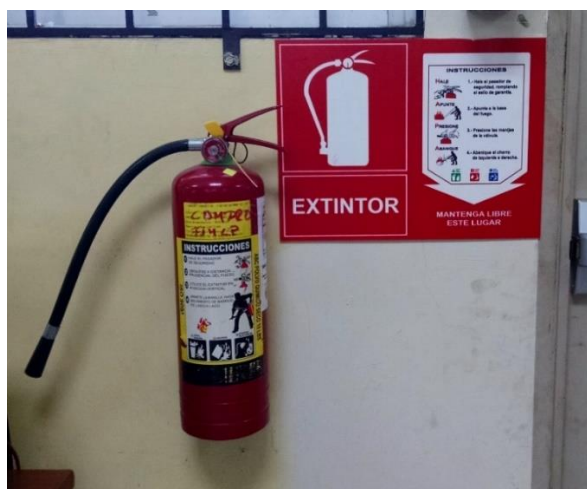
FIGURA 3.58: Extintor 1 de PQS del Laboratorio CAMPRO
