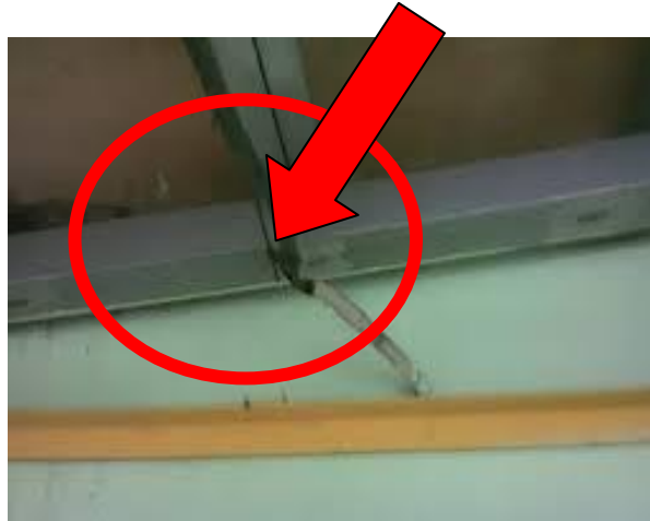
FIGURA 4.3 PROTECCIÓN DE INSTALACIONES ELÉCTRICAS
