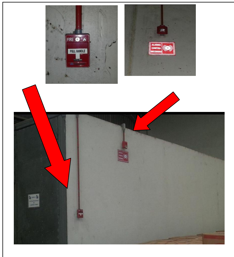
FIGURA 4.14 SISTEMA CONTRA INCENDIOS
