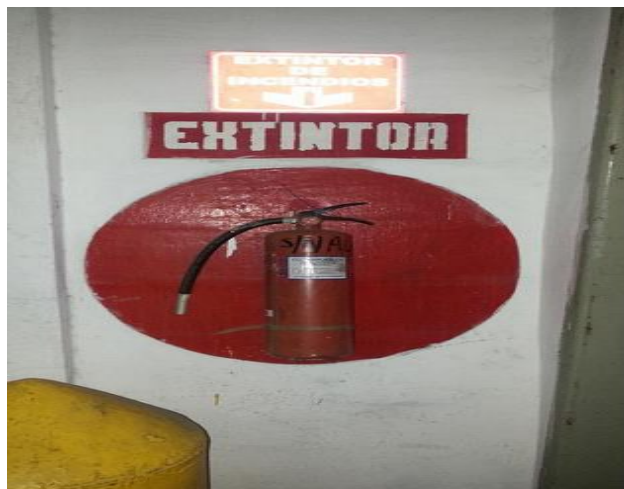
FIGURA. 4.7 IDENTIFICACIÓN DE EXTINTOR
