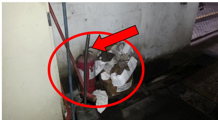
FIGURA.3.12 MALA UBICACIÓN DE LOS EXTINTORES
