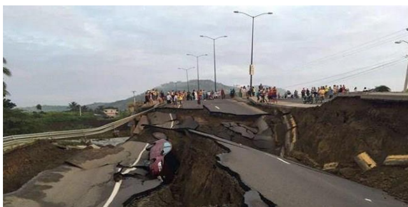
Figura 1.4: Carretera destruida vía Pedernales. [5]
