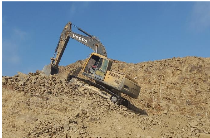
Figura 1.2 Excavadora Volvo EC240CL
