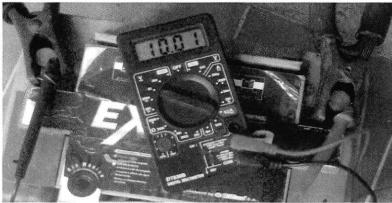
Figura 23. Voltaje inicial de la batería antes comenzar el proceso de carga
