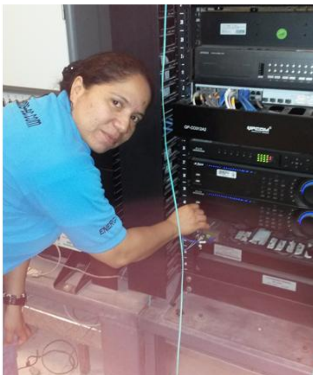
Figura 2.10: Instalación y puesta en marcha de NVR DOTIX
