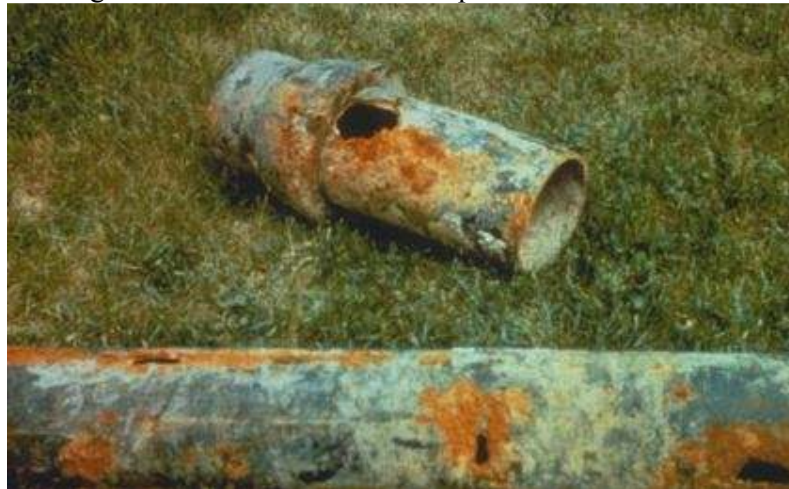
Fotografía de Material deteriorado por condiciones del Suelo
