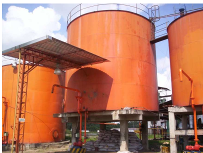
Figura 9. Tanques de almacenamiento
