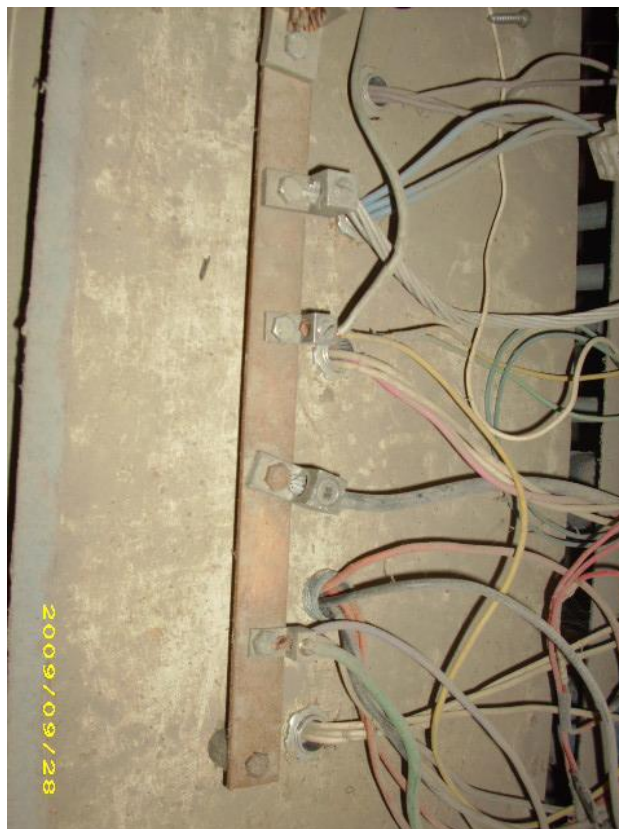
Fig. 11: Instalaciones con oxido [8]
