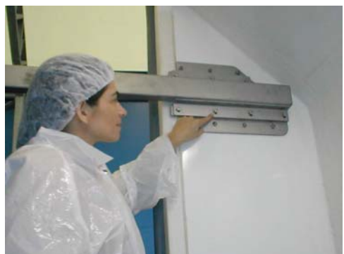
La instalación se hace en un par de días y es limitado a la conexión de la refrigeración, el agua, aire comprimido y electricidad
