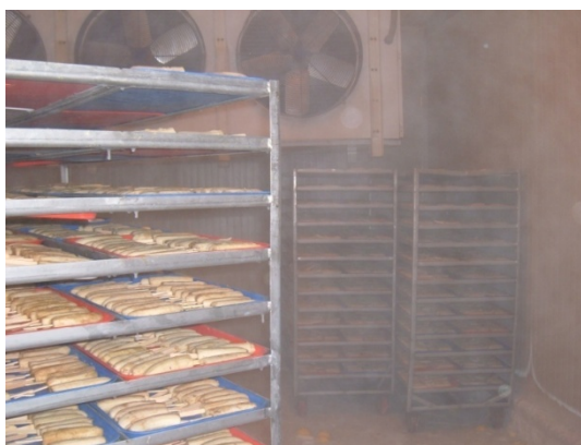
FIGURA 1.8 CUARTO DE ENFRIAMIENTO.
