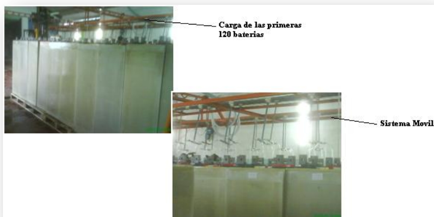
FIGURA 3.4 DISPOSICION DE BATERIAS EN CUARTO DE ACTIVACION CON SISTEMA DE DESPLAZAMIENTO
