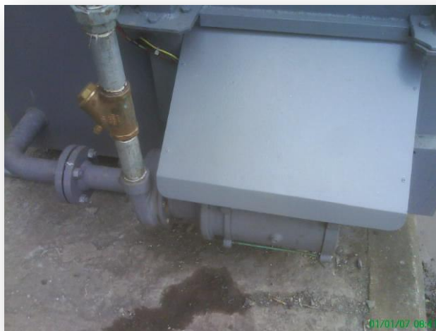
FIGURA 5.4. BOMBA DE AGUA PARA TORRE DE ENFRIAMIENTO
