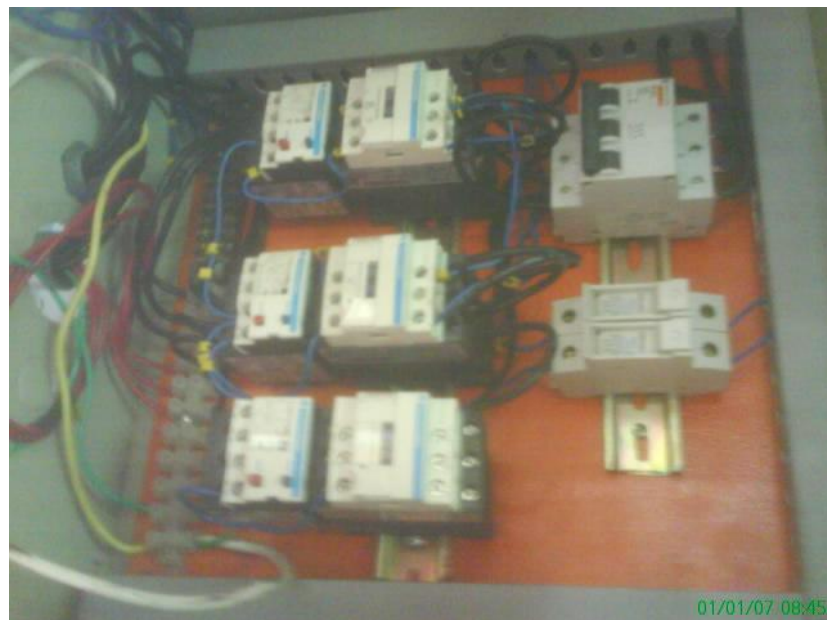
Sistema Eléctrico para Activación de Elementos de La torre De Enfriamiento
