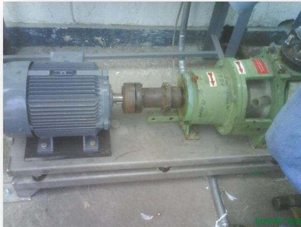
FIGURA 5.3. BOMBA PARA AGUA DESTILADA QUE ENTRA EN LAS BATERIA
