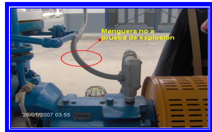
Figura 3. Manguera de conexión no a prueba de explosión
