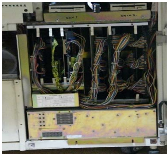
Figura 9: Cableado totalmente nuevo y bien estructurado.
