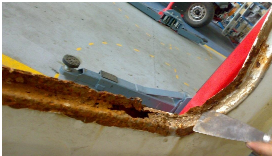
5-6 VENTANA POSTERIOR DETERIORADA
