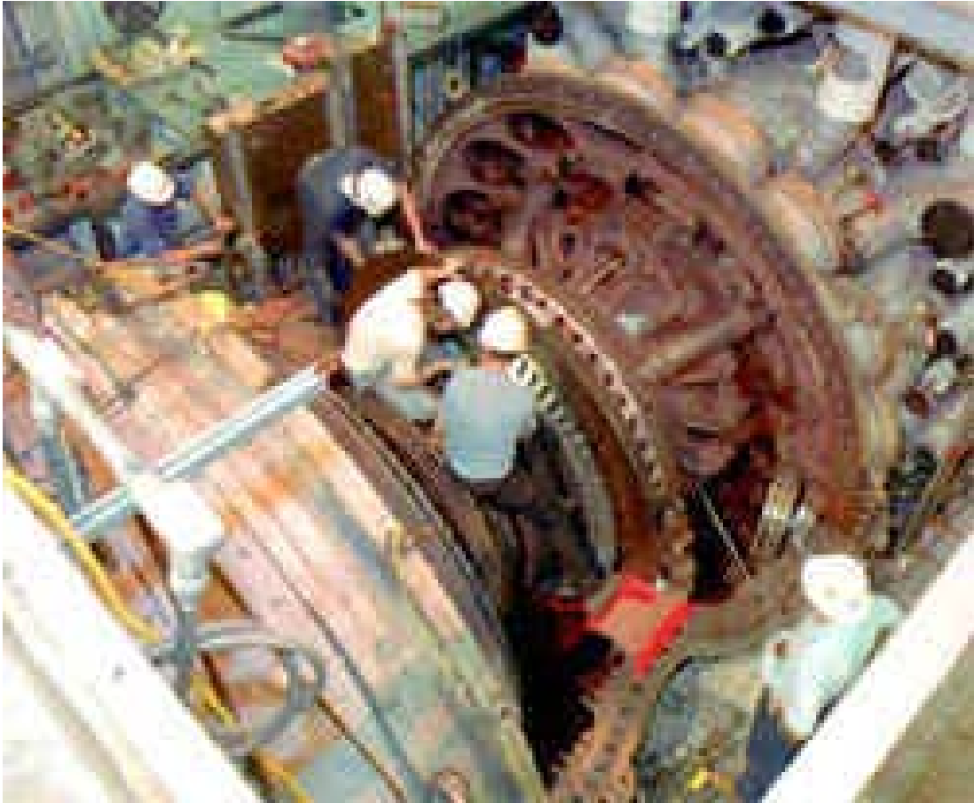
FIG.7.1. MANTENIMIENTO DE UNA TURBINA DE TIPO INDUSTRIAL
