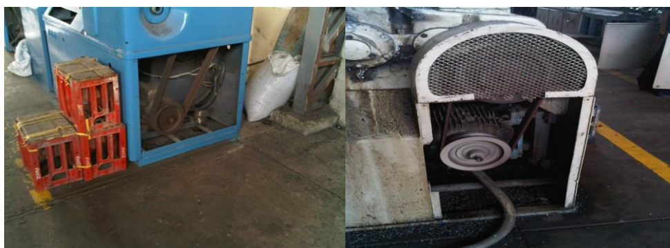
FIGURA 4.11 FALTA DE GUARDAS EN LAS MÁQUINAS
