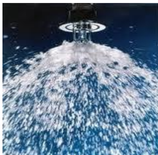
FIGURA 6.6 ROCIADOR DE AGUA
