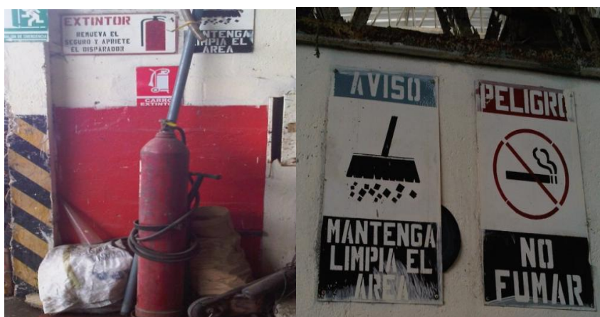
FIGURA 4.14 EXTINTOR Y RÓTULOS DE SEGURIDAD
