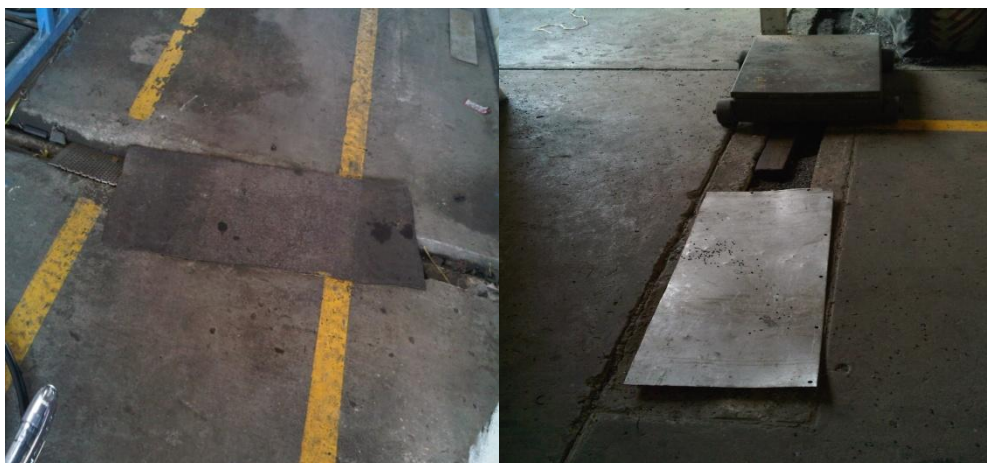
FIGURA 4.10 TAPAS RÚSTICAS EN LOS DRENAJES
