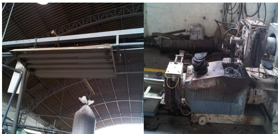
FIGURA 4.9 LÁMPARAS Y EQUIPOS EN DETERIORO
