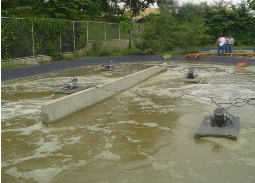
Digestor: confinamiento y reducción final de lodos.
