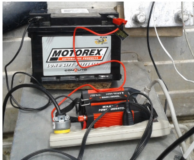
Figura No. 52 Batería de 12 V e Inversor
