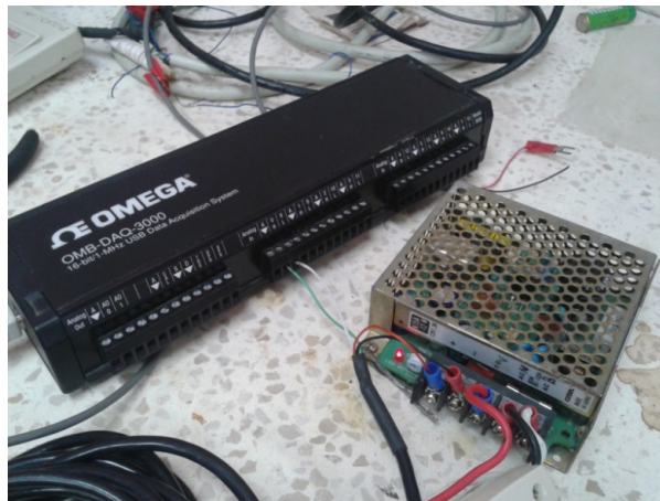
Figura No. 53 Tarjeta de Adquisición OMEGA con cables de Celda de Carga conectados a la misma y a la Fuente de Poder
