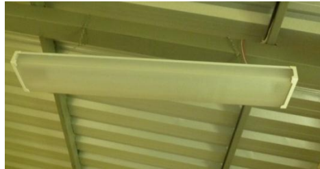
Figura 3.5 Protector de lámpara instalado.
