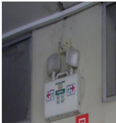
FIGURA 3.5 LUZ DE EMERGENCIA
