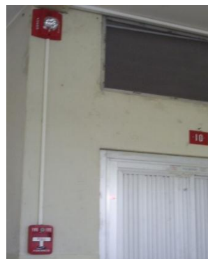
FIGURA 3.6 ALARMA DE FUEGO
