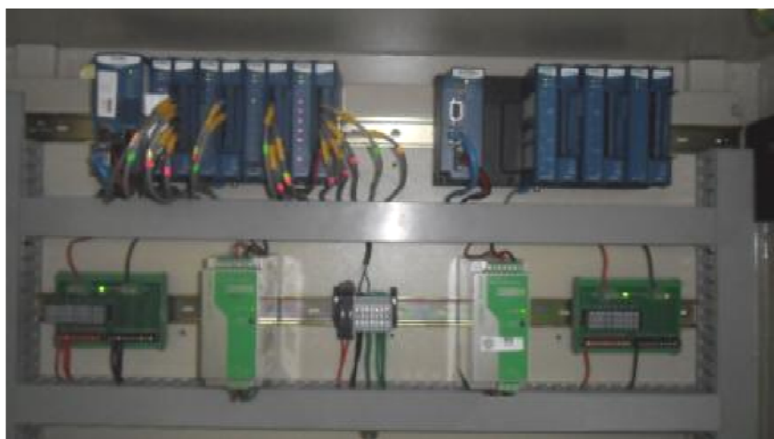
Figura 3.20 Conexiones efectuadas en los equipos de campo basándonos en los 3 códigos
