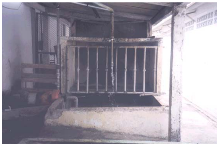
Figura 2. Cisterna de enfriamiento
