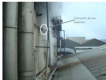
Figura 8. Pérdida de vapor al ambiente
