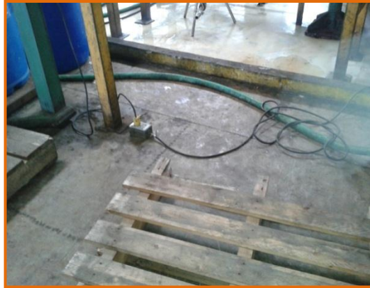
Figura 4.3 Cables Sin Protección
