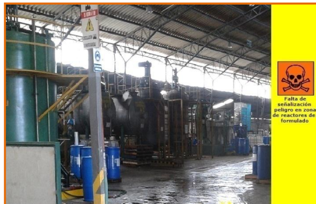
Figura 4.5 Zona De Reactores Sin Señal De Peligro
