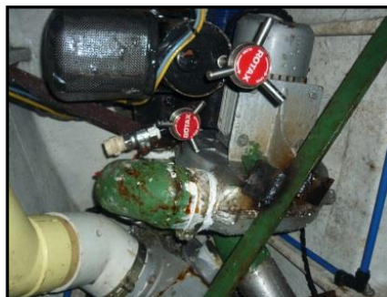
Extracción y válvulas de cierre.
