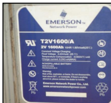
Acumuladores de energía (baterías)
