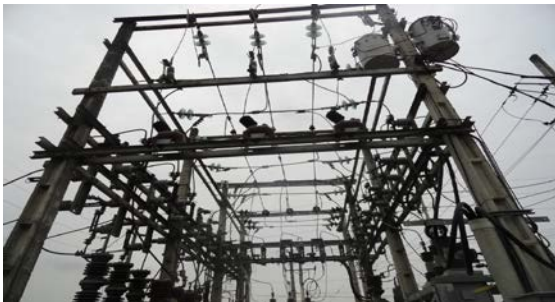
Figura 4. Patio de 13.8 KV
