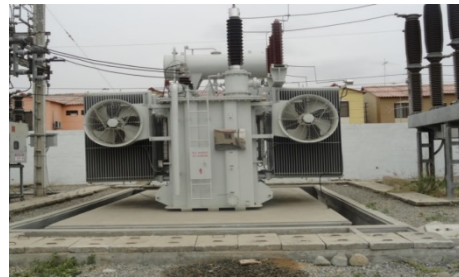
Figura 3. Transformador de potencia 24/30 MVA
