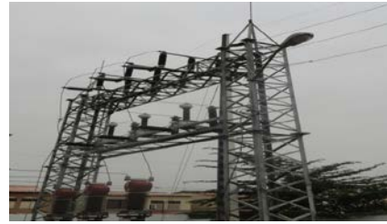
Figura 2. Vista de la estructura de 69 Kv
