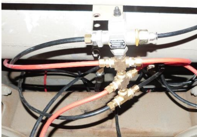
Fuente y elaboración: Los Autores Figura 4. 14 Válvula de doble retención
