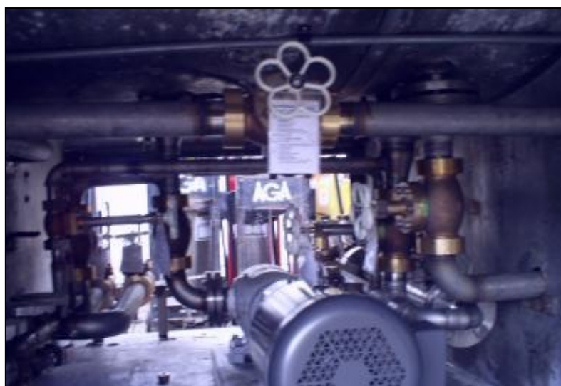
Figura 3.8. Vista de la válvula de habilitación del gabinete de descarga posterior
