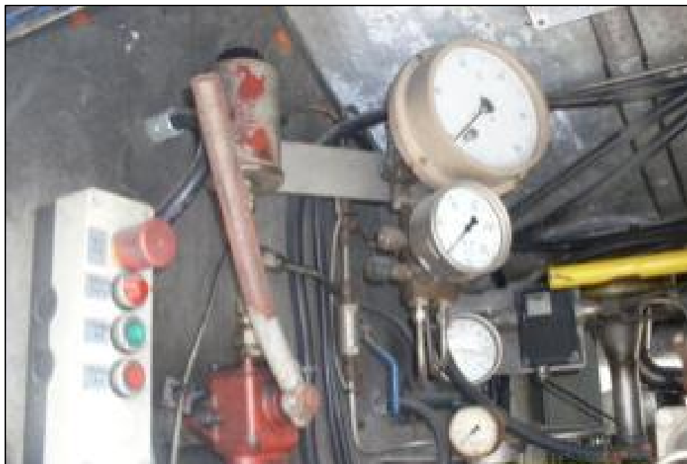
Figura 2.12. Detalle de botoneras de mando de Bomba eléctrica, válvula de accionamiento de Bomba hidráulica y Medidores de nivel y presión del Tanque y Bombas respectivamente
