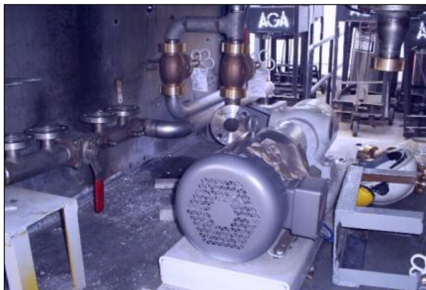
Figura 3.2. Ubicación de la Bomba y Válvulas V2 y V4
