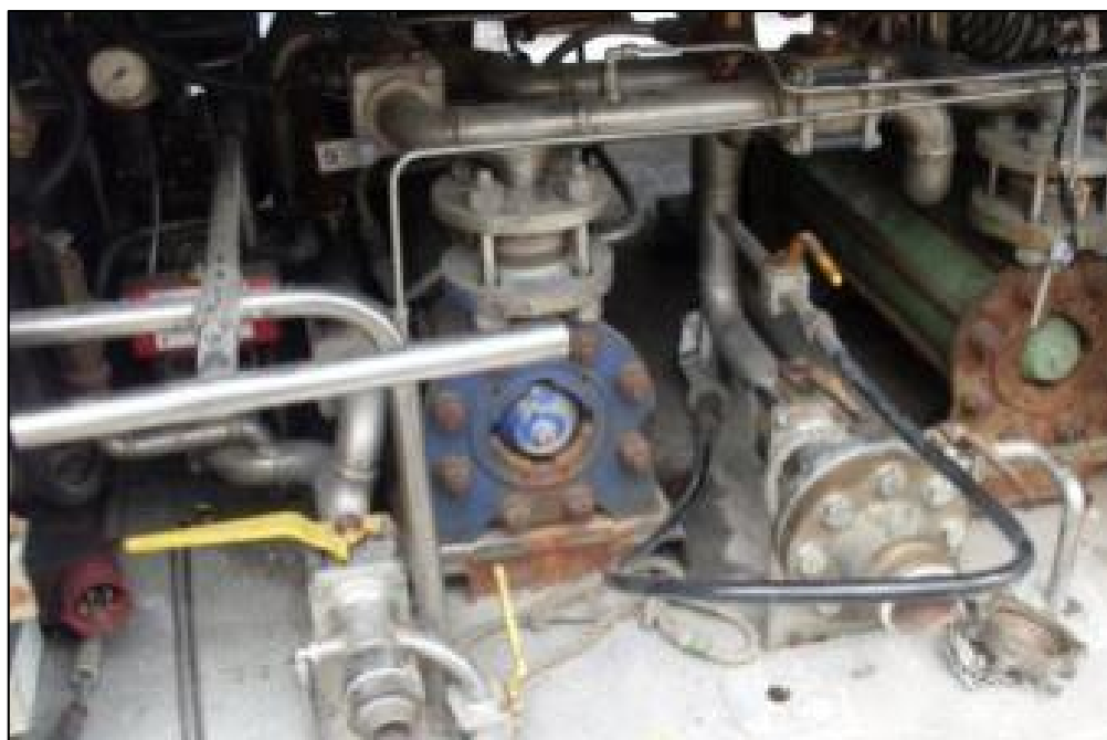
Figura 2.10. Vista Frontal del Gabinete con las dos bombas en primer plano y las tomas X3 y X6
