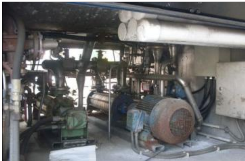
Figura 2.7. Vista posterior del gabinete con detalle de las dos bombas
