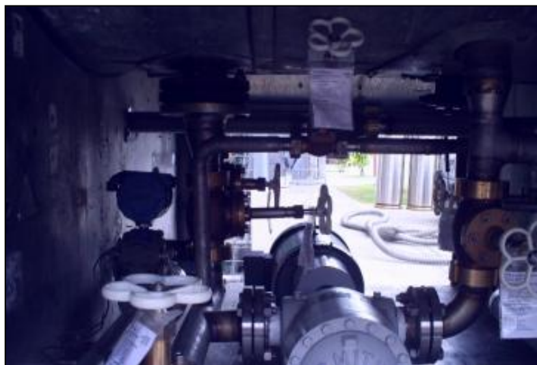
Figura 3.7. Tramos de succión y descarga de la bomba
