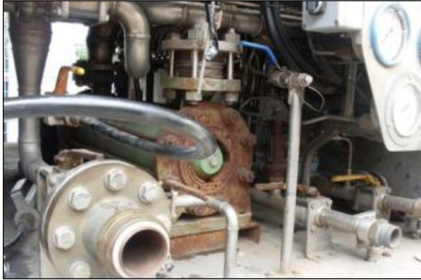
Figura 2.6. Fotos de gabinete de valvulería inferior del tanque, detalle de la bomba de hidráulica.
