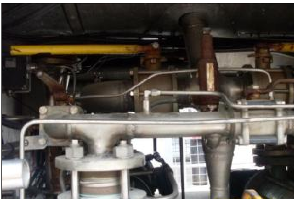
Figura 2.4. Foto de gabinete de valvulería inferior del tanque, detalle de las válvulas principales 2 y 4 (mango amarillo).
