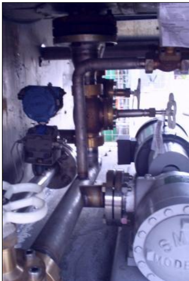
Figura 3.6. Vista de instalación de flujómetro Autor: Carolina Casal Q.
