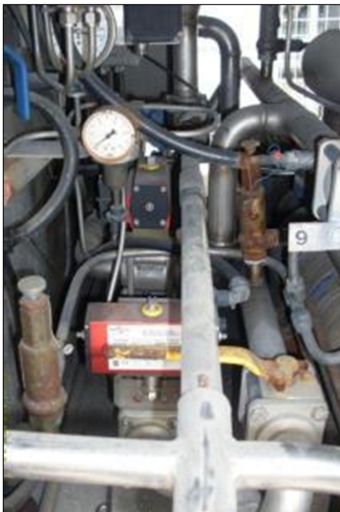
Figura 2.9. Detalle de válvulas de seguridad. Manómetros e indicador de nivel
