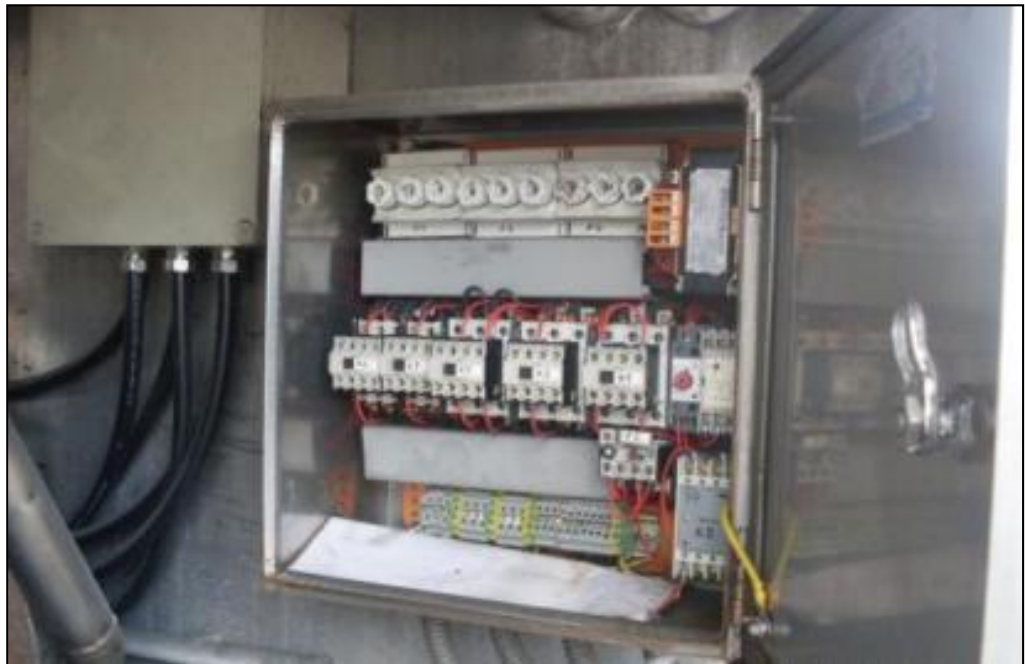
Figura 2.14. Tablero eléctrico de fuerza y control
