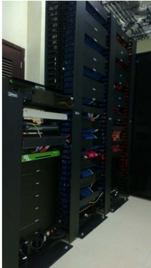
Figura 1-1. Cableado Estructurado del Centro de Procesamiento de Datos
