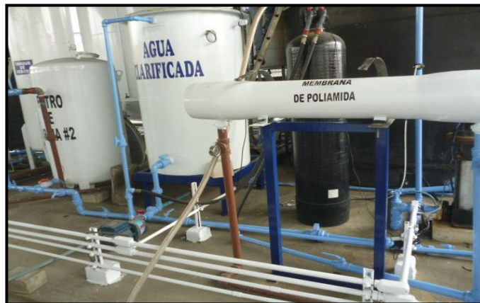
FIGURA 4.8 TANQUES DE PASO DE AGUA RESIDUAL
