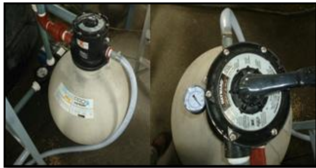
FIGURA 4.5 FILTRO DE ARENA
