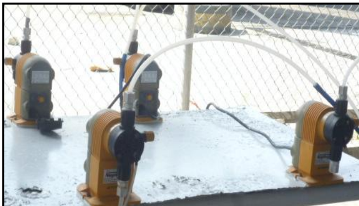
FIGURA 4.10 DOSIFICADORES DE QUÍMICOS
