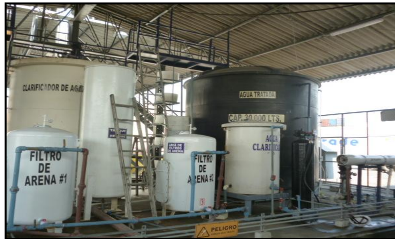
FIGURA 3.8 PLANTA DE TRATAMIENTO DE AGUAS RESIDUALES
