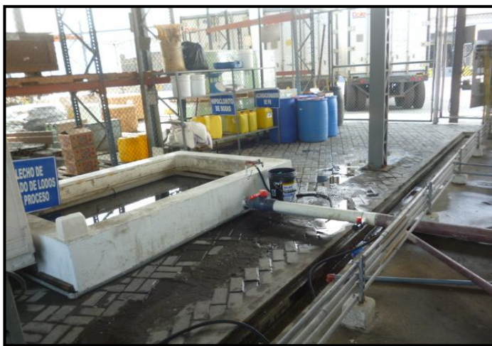
FIGURA 3.10 LECHO DE SECADO DE LODOS
