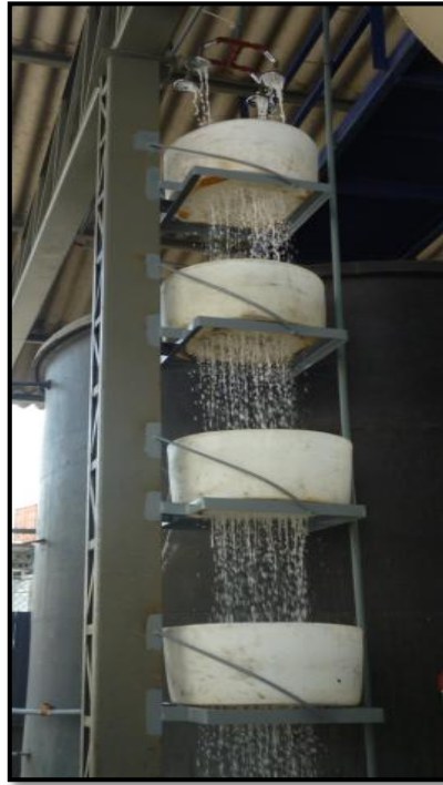
FIGURA 4.4 TORRE DE AIREACIÓN
