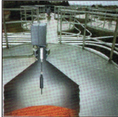
FIGURA 3.7 Sistema electromecánico de medición de nivel
