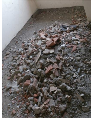
Fotografía 2.5: Restos de escombros.
