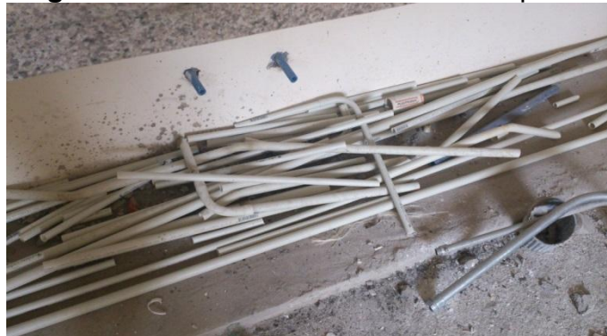
Fotografía 2.3: Sobrantes de tuberías de plástico.
