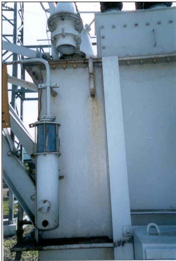
FIGURA 1.38. SECADOR DE SILICA GEL MONTADO EN UN TRANSFORMADOR.
