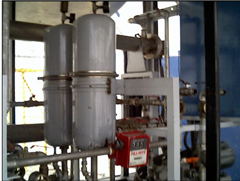
FIGURA 5.5. FILTROS DE CARTUCHO Y MEDIDOR DE FLUJO
