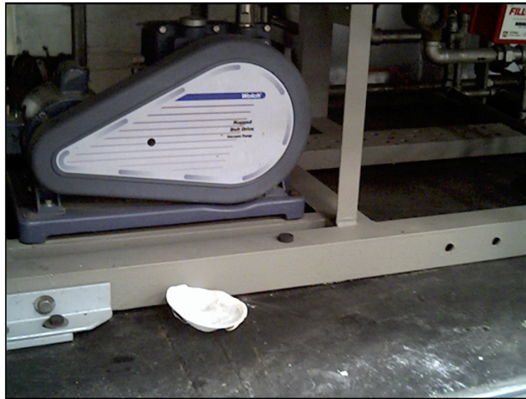
FIGURA 5.7. BOMBA DE VACÍO
