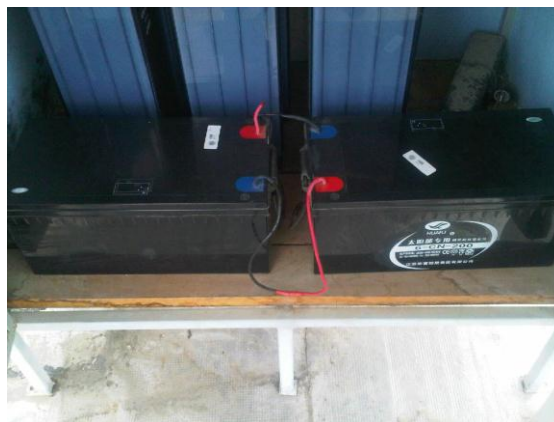
Figura 3.12 Banco de baterías sistema eólico
