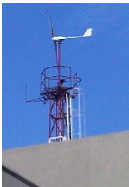
Figura 3.5 Aerogenerador del Lab. FREE – ESPOL
