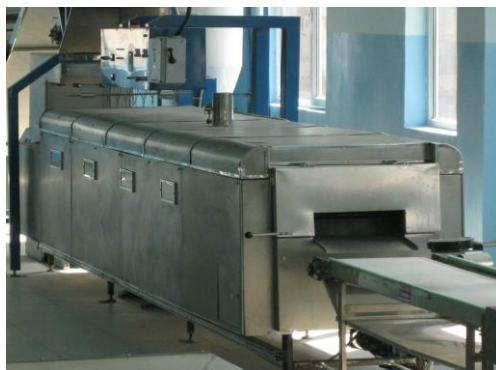
FIGURA 2.12 HORNO DE TÚNEL
