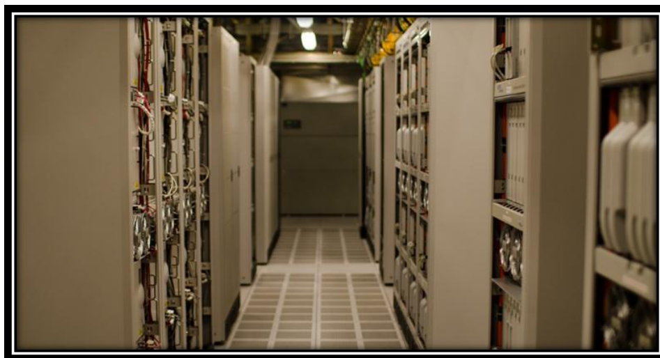
Figura 2.8 Centro de Conmutación Móvil
