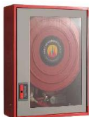
Boca de incendio equipada de 25 mm
