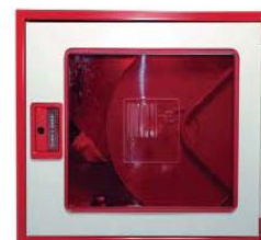
Boca de incendio equipada de 45 mm
