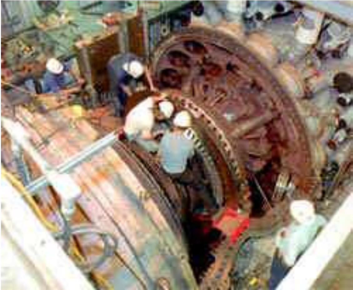
FIG.7.1. MANTENIMIENTO DE UNA TURBINA DE TIPO INDUSTRIAL
