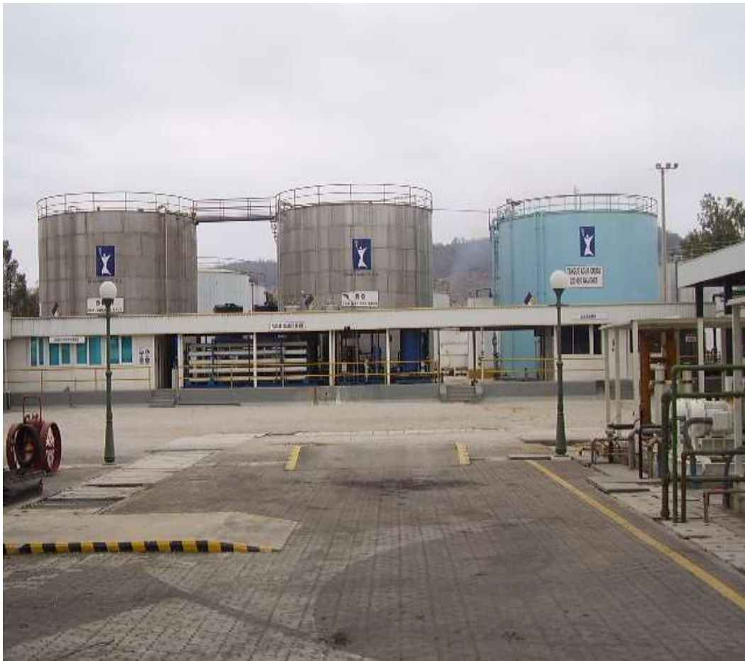
FIGURA G.1 TANQUES DE ALMACENAMIENTO DE AGUA
