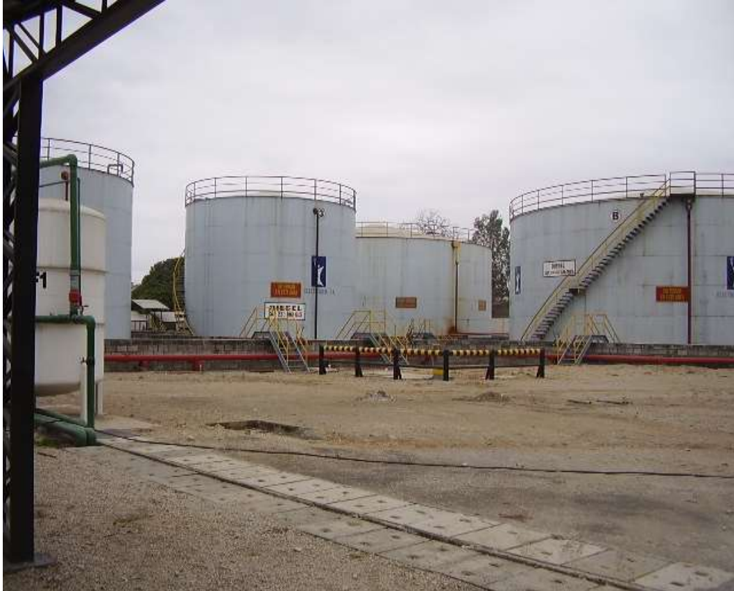
FIGURA G.3 TANQUES DE ALMACENAMIENTO DE COMBUSTIBLE
