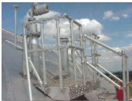
FIGURA 3.23 CABINA DE AFORO
