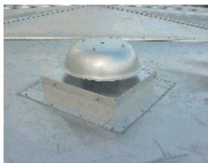
FIGURA 3.21 VALVULA DE VENTEO CENTRAL
