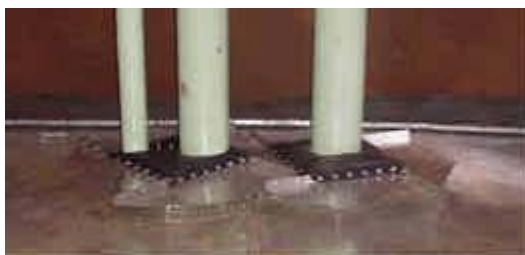
FIGURA 3.19 TUBOS DE INSTRUMENTACION
